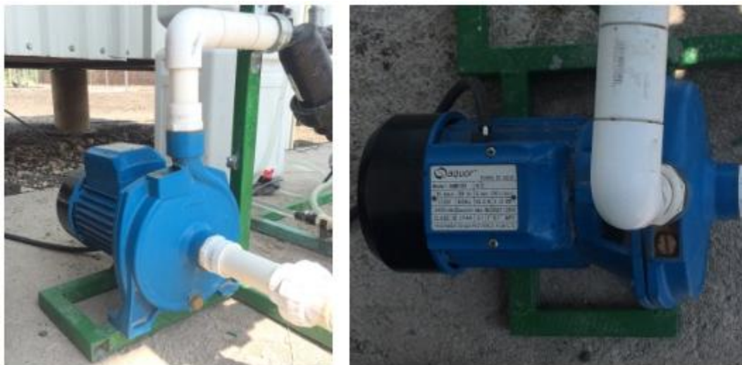
Figura 3.2 Sistema de bombeo
