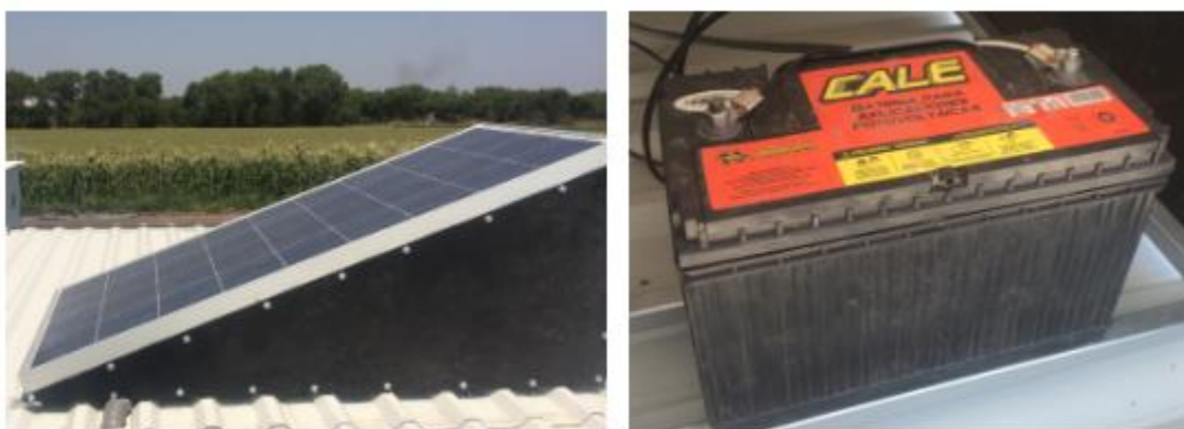
Figura 4.4 Panel fotovoltaico y batería instalada
