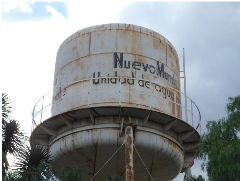
Unidad de almacenamiento de agua
