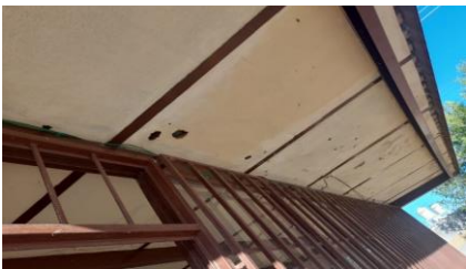
Imagen 3: Cuarteaduras por fuera
