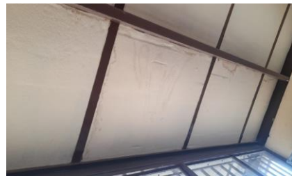
Imagen 4: Filtración de agua en el aula
