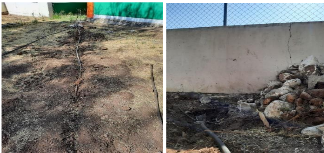
Imagen 3. Líneas de agua expuestas en el plantel escolar Lobatos
