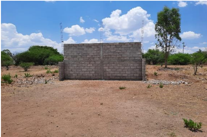
Imagen 10. Proyecto cancha de rebote inconclusa
